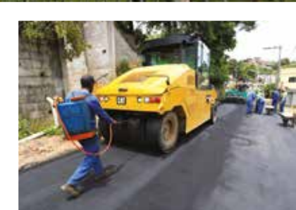
Pavimentação asfáltica na Avenida do Congo e na Rua 1º de Maio
